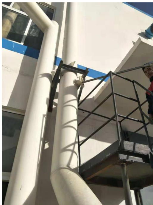
喷淋塔排气筒监测孔
